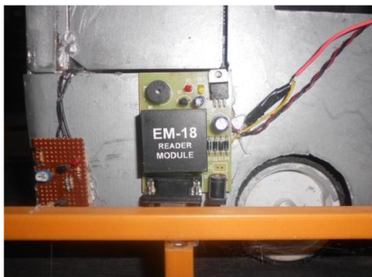
ภาพที่ 2-6 RFID Reader and Vibration Sensor at the Entrance of the Bus (Vidyasagar, Balaji and Reddy, 2015)
